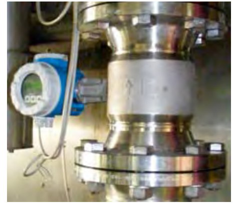
Bild 4: Vortex-Durchflussmessung in der ND-Druckleitung
