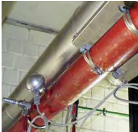
Bild 5: Ultraschall-Durchflussmessung an einer der beiden HD-Druckleitungen. Zur Umrechnung auf den Massenstrom werden an der gleichen Stelle Druck und Temperatur erfasst.
