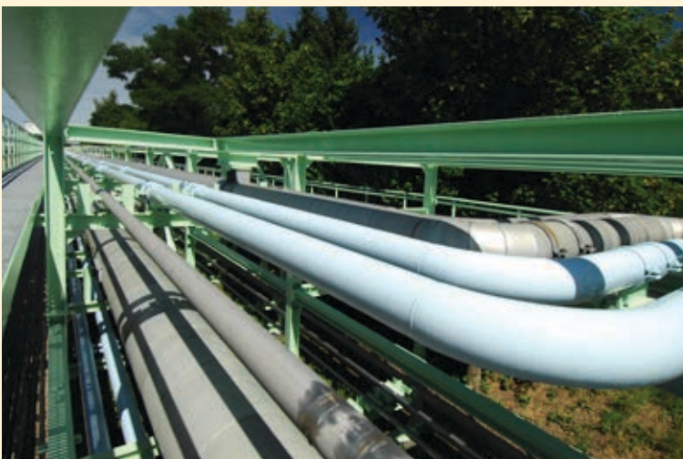
Abb. 4 Versorgungsleitungen im Chemiepark Knapsack
